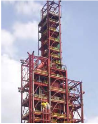
Essar Steel Module V
